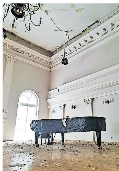
Die Konzerthalle des Instituts wurde im März schwer beschädigt.
